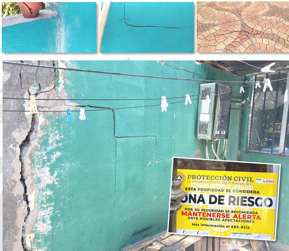
GRIETAS EN BARDAS. Afectaciones de importancia en bardas perimetrales.
